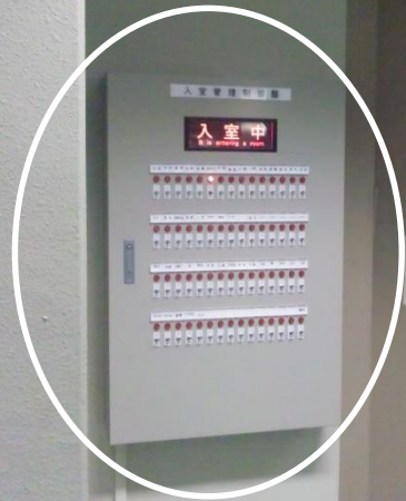
入退室監視盤
